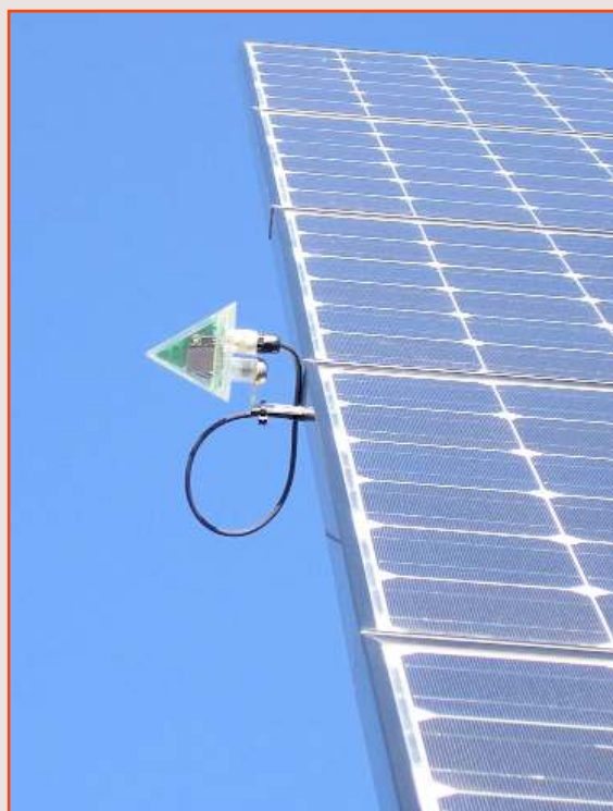
* Detall d'una placa solar fotovoltaica amb sensor de seguiment
